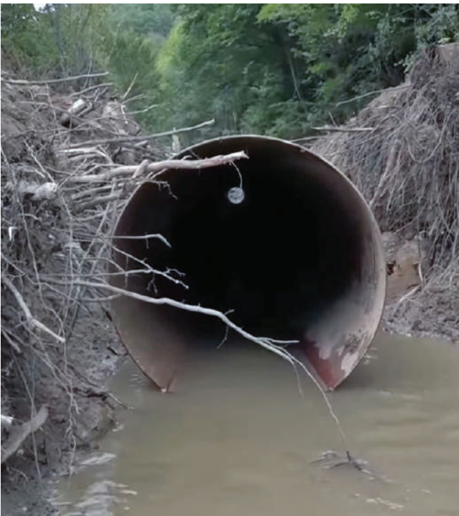
Изглед цијеви за довод воде до машинског постројења
